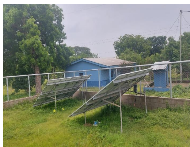
Figura 10. Paneles solares que proporcionan energía para el abastecimiento de agua.
