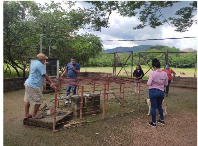
Figura 8. Bomba de extracción de agua del reservorio para su distribución
