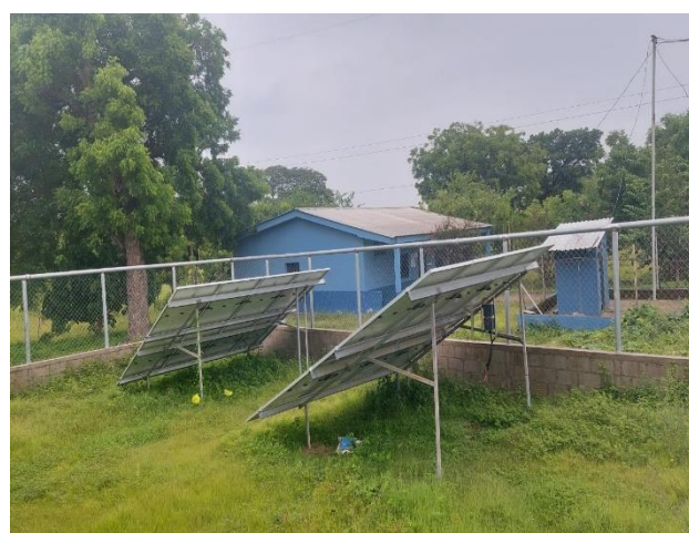
Figura 9. Paneles solares que proporcionan energía para el abastecimiento de agua.
