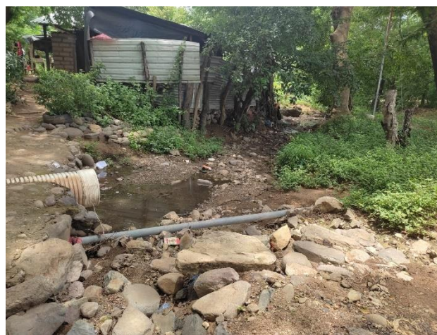
Figura 10. Tuberías de aguas grises en mal estado
